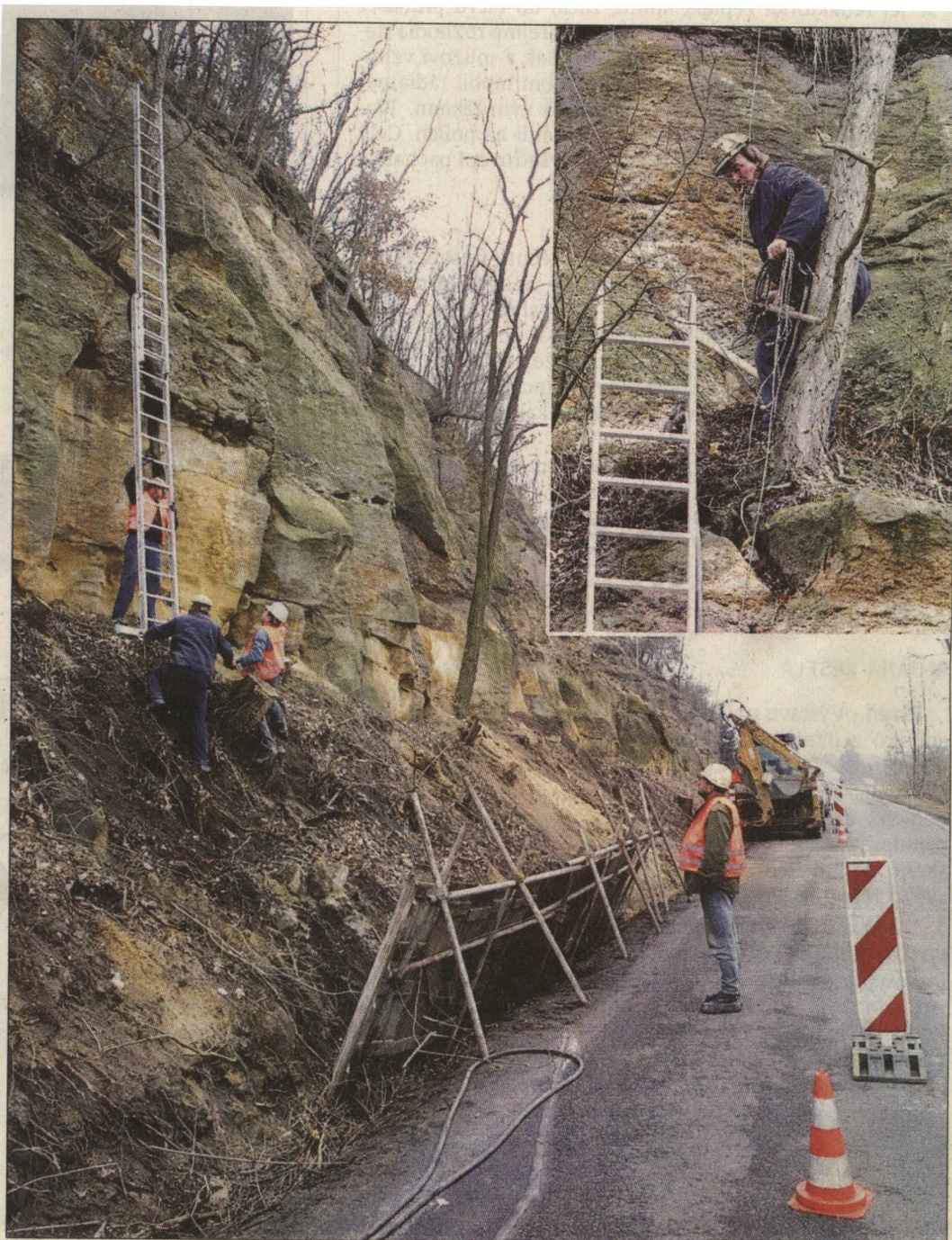
Po žebříku na skálu a pak sbíječkou postupně odlupovat kusy zvětralého pískovce. Do konce týdne zmizí balvan, u kterého se odborníci obávali pádu na silnici spojující Plzeň s Radčicemi. Foto Zdeněk Vaiz
