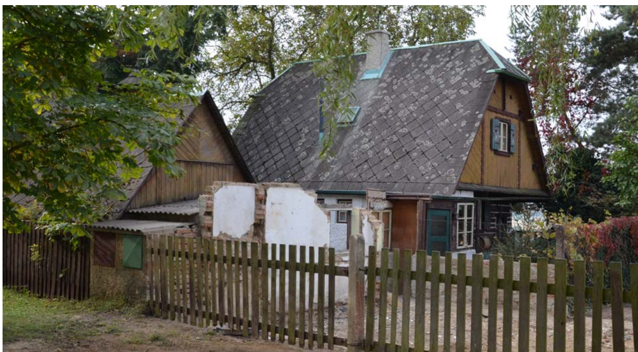
západní část usedlosti – probíhající demolice postižené budovy dřevomorkou
