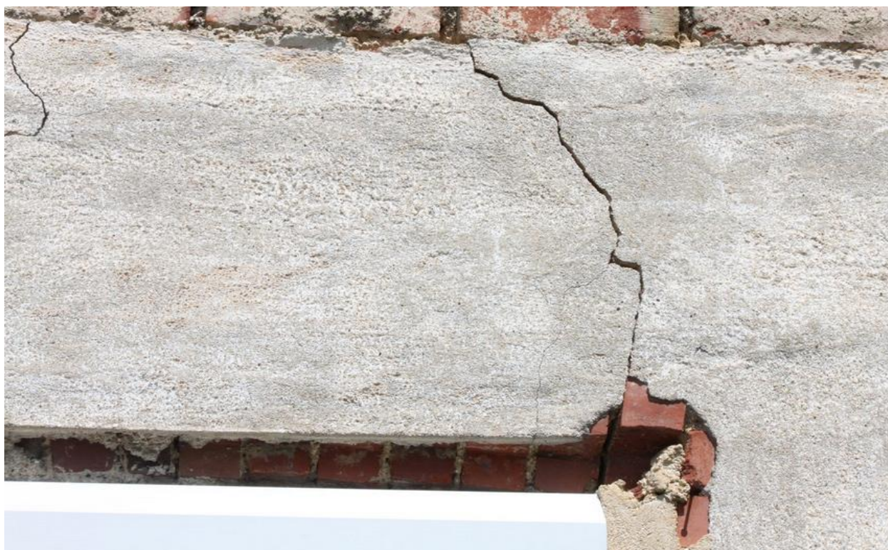
prasklina na domu v Toužimi
